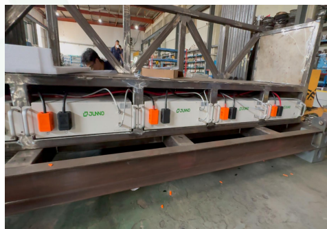
▼ 储能系统 / BESS
