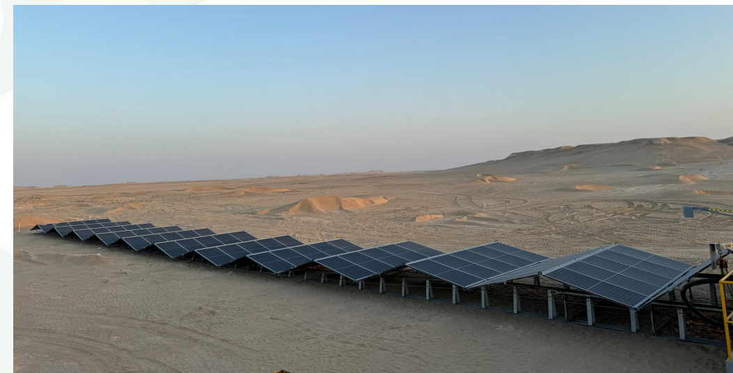
■ 中东·石油天然气开采场140KWp移动光伏电站 Middle East - Oil & Gas Field 140KWp Mobile PV Plant
